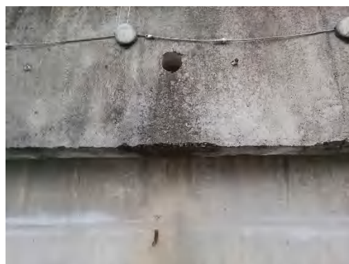
泄水管未伸出梁体
