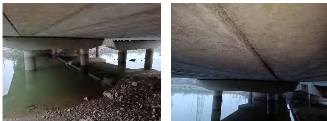
主梁空心板底混凝土剥离、露筋锈蚀、铰缝脱落
