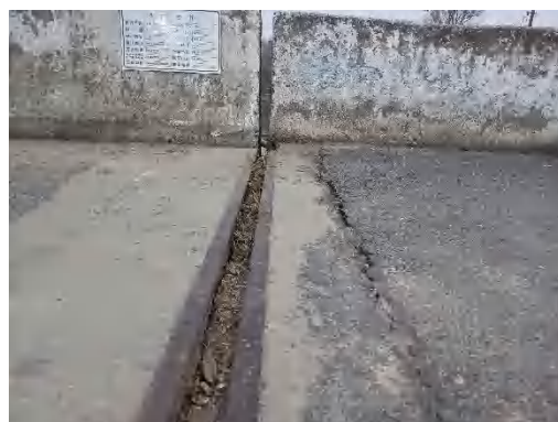
伸缩缝堵塞、锚固区破损
