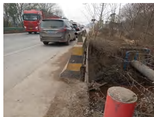
护栏表面破损，长度不足， 钢扶手锈蚀严重
