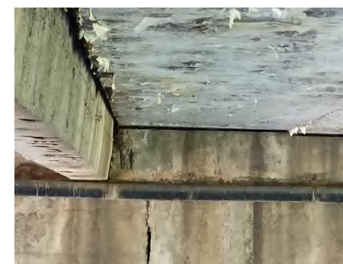
台帽钢筋锈蚀、混凝土剥落
