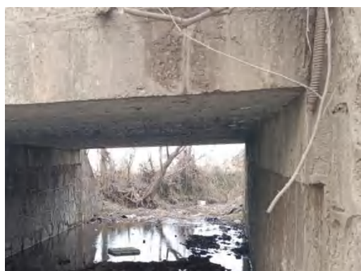
主梁板底混凝土裂缝、剥离、露筋锈蚀
