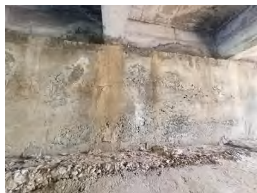
台身横向贯通裂缝
