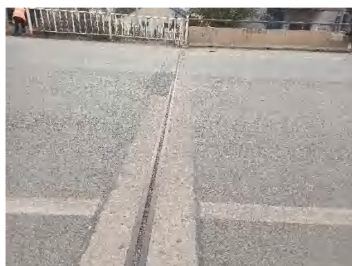
伸缩缝堵塞、缺失
