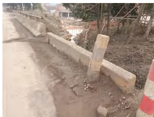
护栏表面破损、长度不足、钢扶手锈蚀
