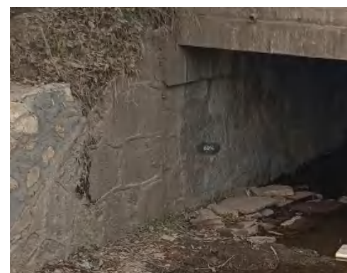
桥台砌缝轻微剥落缝
