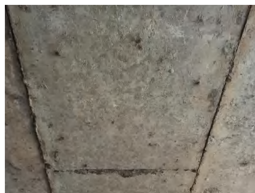
空心板勾缝局部脱落
