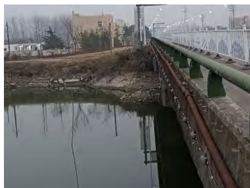
护栏钢扶手锈蚀
