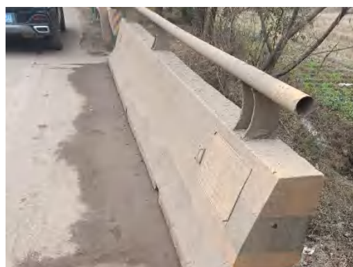
护栏表面破损、长度不足、钢扶手锈蚀
