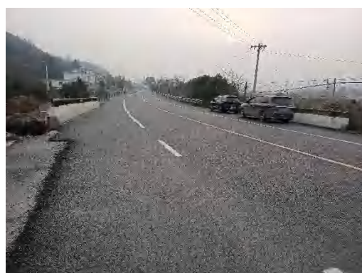
桥头未设置伸缩缝
