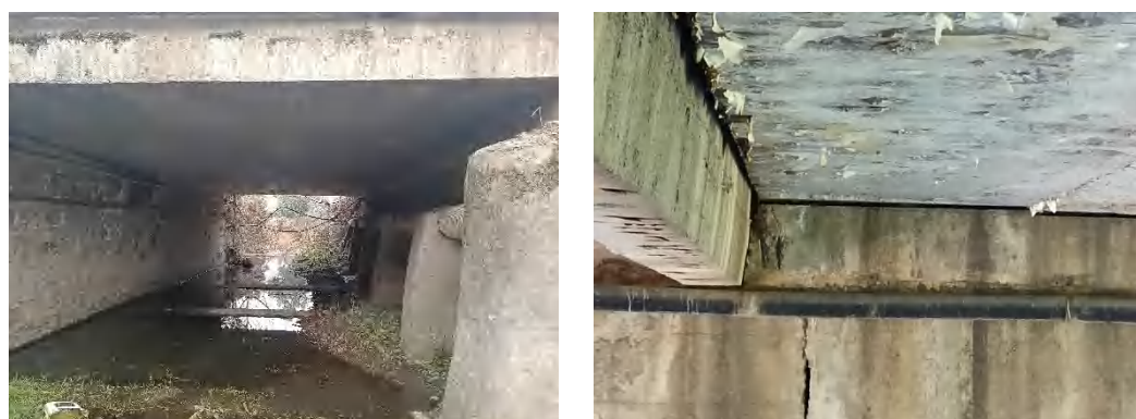
桥台台身冲刷剥落
