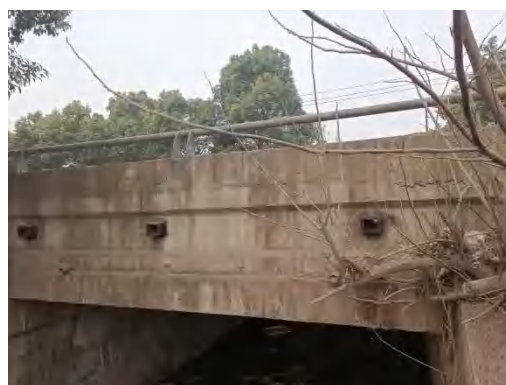
泄水孔铸铁管锈蚀破损
