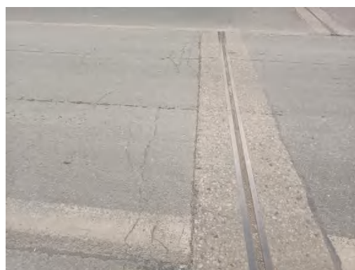
台后路面裂缝、伸缩缝堵塞， 锚固区破损
