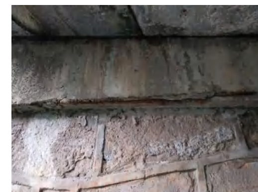
台帽钢筋锈蚀、混凝土剥落
