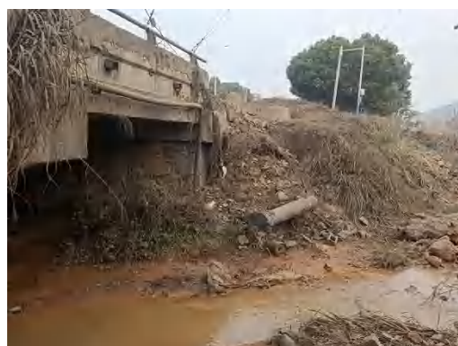
锥坡破坏、泄水孔铸铁管锈蚀破损
