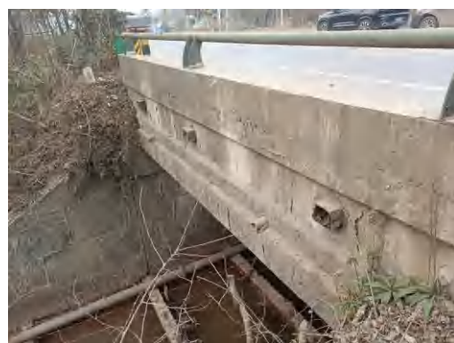
泄水孔铸铁管锈蚀破损
