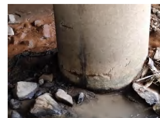
柱墩混凝土剥落
