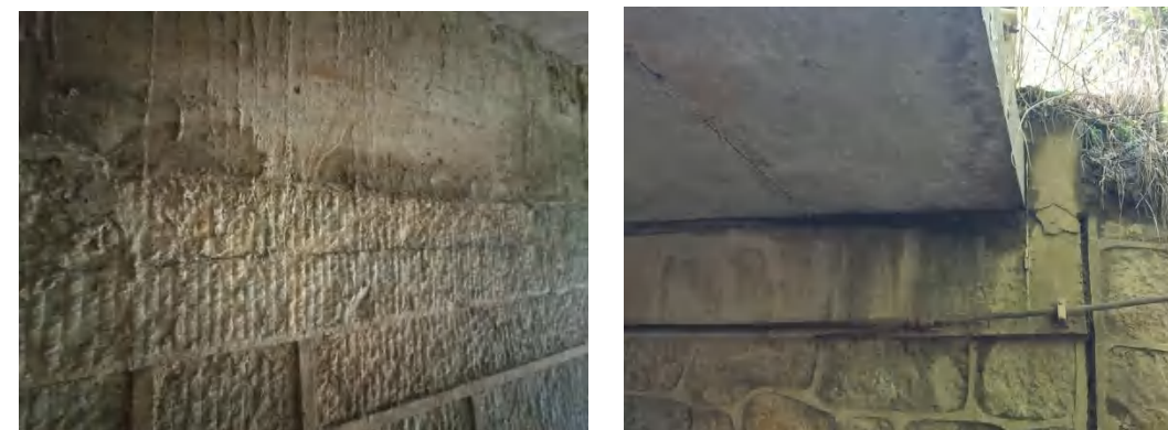
桥台砌缝轻微剥落、裂缝
