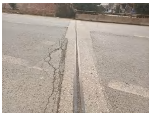
东侧伸缩缝堵塞，锚固区破损
