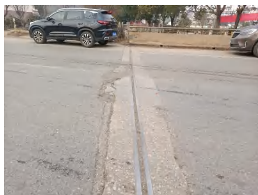
西侧伸缩缝型钢错位、锚固区破损
