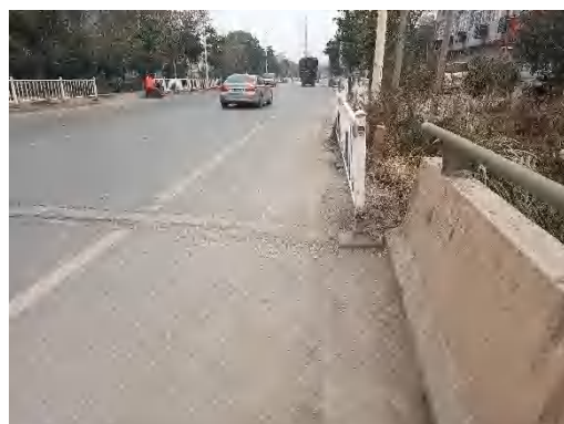
护栏长度不足、钢扶手锈蚀
