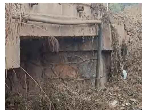
桥台砌缝轻微剥落缝
