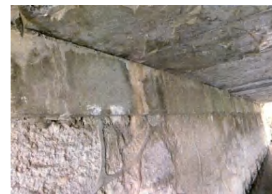
台帽钢筋锈蚀、混凝土剥落、裂缝
