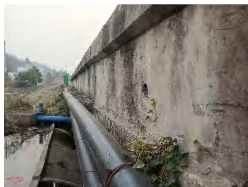
泄水管未伸出梁体
