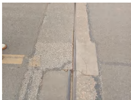
西侧伸缩缝堵塞, 锚固区破损
