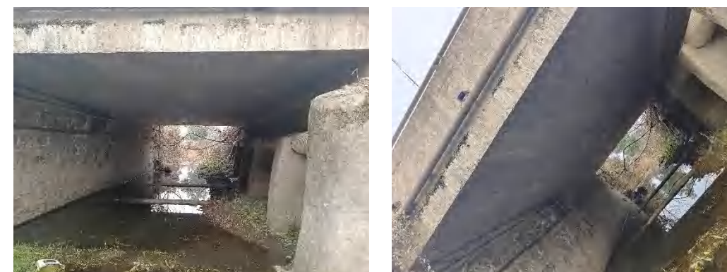
主梁空心板底混凝土剥离、露筋锈蚀
