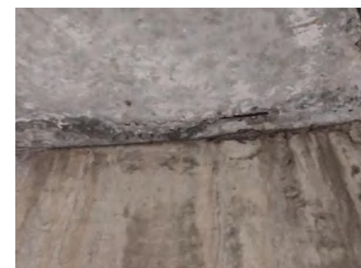
主梁板底混凝土剥离、露筋锈蚀
