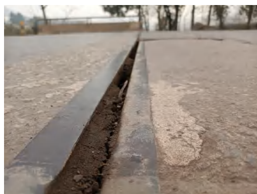
东侧伸缩缝型钢错位、锚固区破损
