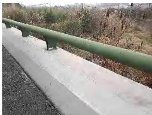
护栏钢扶手锈蚀
