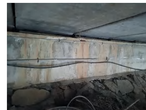
台身贯通裂缝、砌缝冲刷剥落
