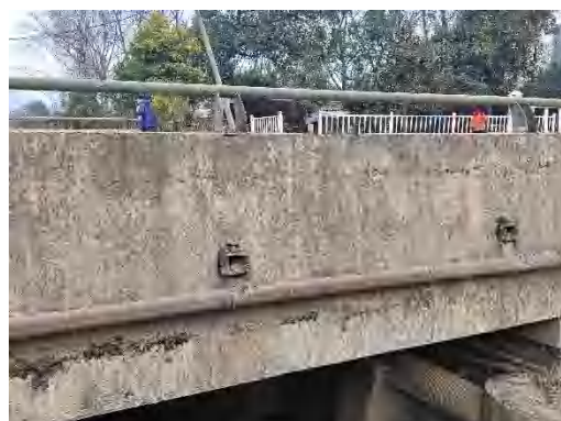
泄水管锈蚀、未伸出梁体 10cm
