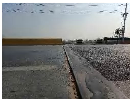
伸缩缝堵塞、桥头不平顺
