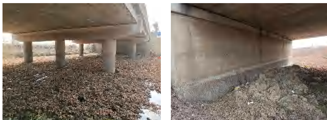
墩台底部混凝土冲刷露骨、桥台渗水痕迹
