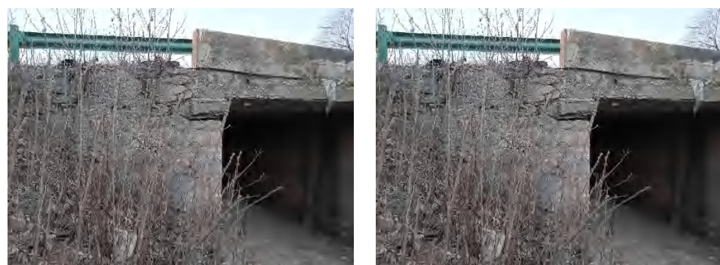
桥台台帽底脱空、砌体松散
