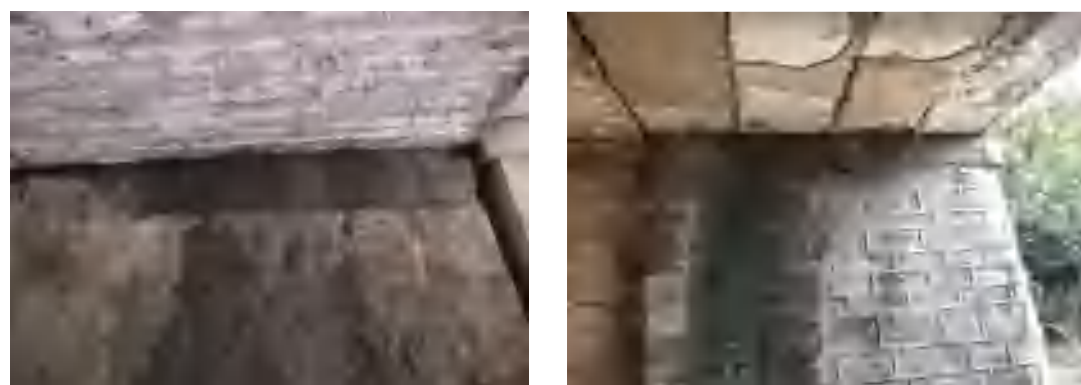
桥墩局部水蚀、混凝土剥落
