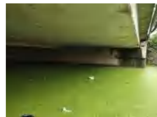
桥台台帽局部混凝土水蚀
