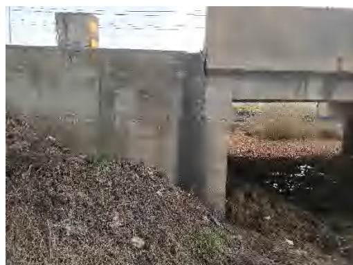
锥坡部位杂草滋生、垃圾覆盖
