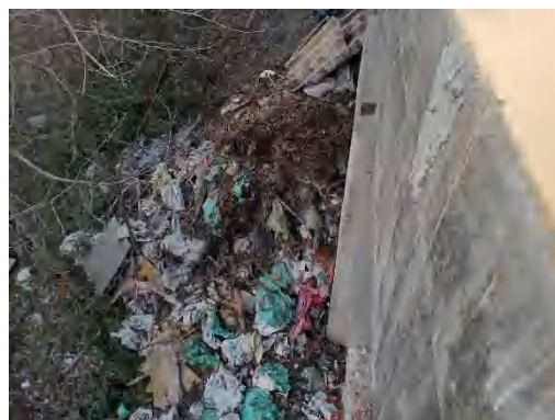
锥坡垮塌被垃圾掩盖
