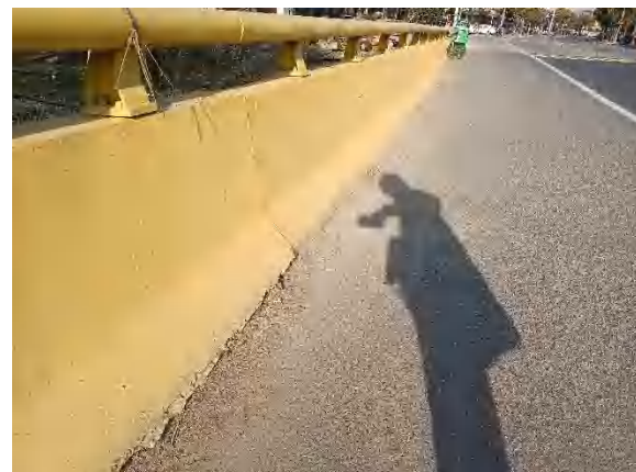
护栏表面破损
