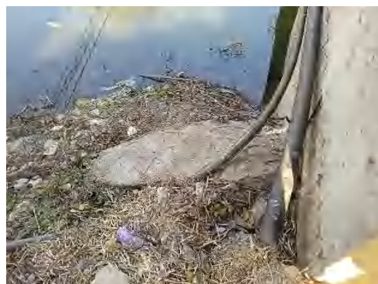
锥坡砌体松动、缺失
