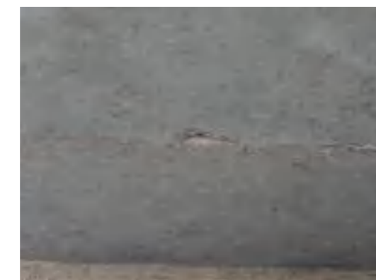
主梁底部混凝土破损
