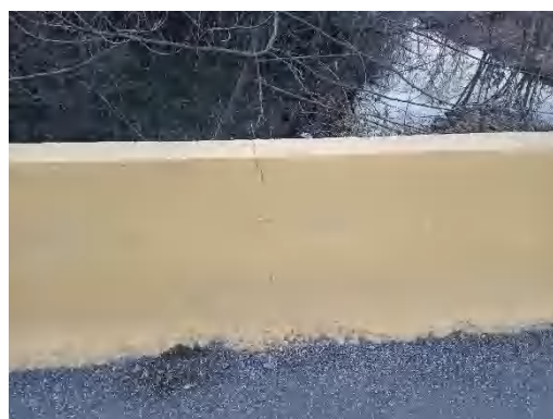
护栏混凝土竖向裂缝
