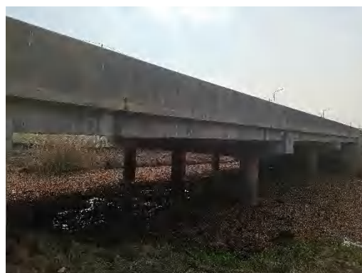
泄水管长度不足，雨水侵蚀梁体
