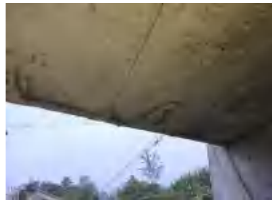
腹板局部混凝土水蚀
