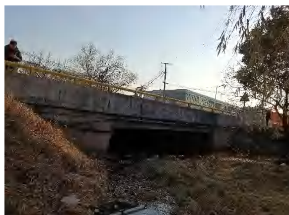
全桥泄水管未伸出梁体
