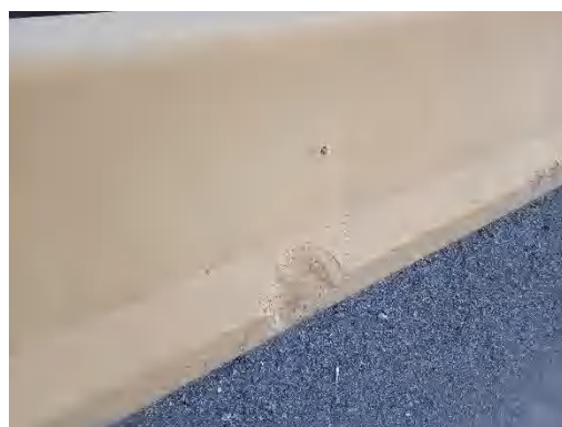
护栏表面混凝土破损
