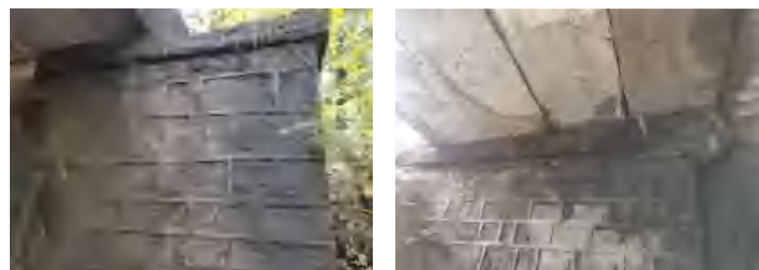
桥台水蚀、混凝土劣化、剥蚀露骨
