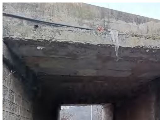
泄水管破损未伸出梁体
