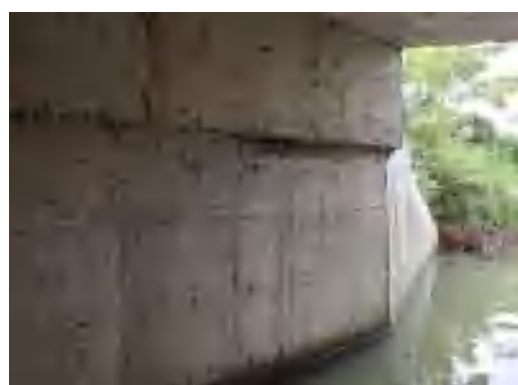
桥台台身混凝土剥落
