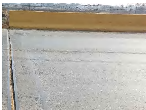
护栏表面混凝土破损
